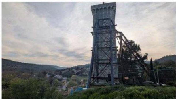
La tour de l'horloge est menacée d'effondrement. / PHOTO THOMAS DUBOZ
