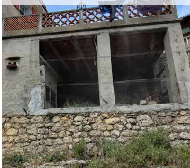
parpaings apparents, garde-corps inadapté
