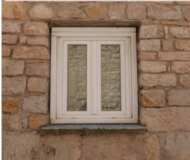
menuiserie PVC non adaptée, pose en rénovation réduisant la surface vitrée
