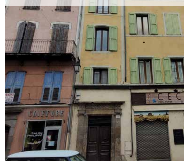
couleurs flash finition d'enduit trop en relief
